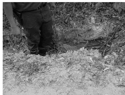
Figura 2: ponto 3 erosão grave em sulco
